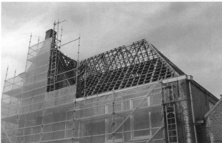
Na het verwijderen van de dakpannen werd de fraaie dakconstructie goed zichtbaar. (foto: mw. B. Koopmans, Zoetermeer)
